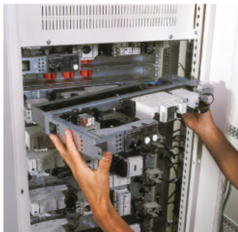
Fig. E31 – Cuadro de distribución con unidades funcionales desconectables
