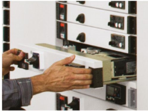
Fig. E32 – Cuadro de distribución con unidades funcionales extraíbles en cajones
